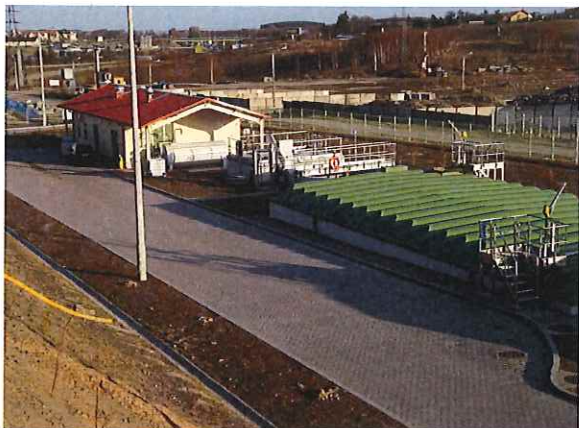
Podczyszczalnia ścieków i odcieków
