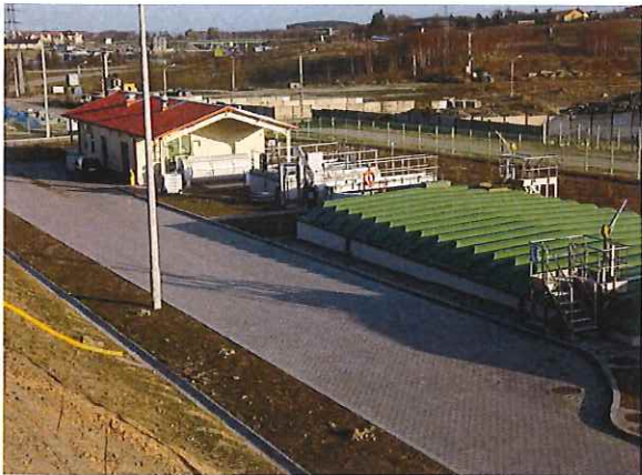
Podczyszczalnia ścieków i odcieków
