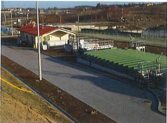
Podczyszczalnia ścieków i odcieków
